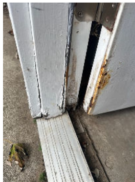
Rotten door and jamb
